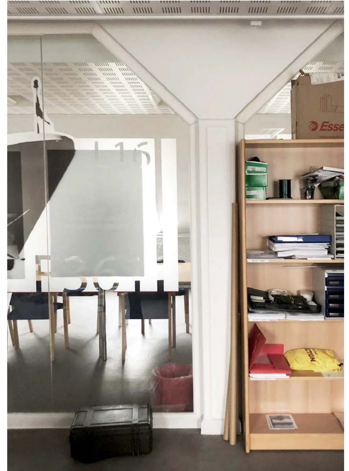
5 Tømmerkonstruktionen i det nordlige Torpedobådskammer er blevet inddækket i gips, hvilket fratager konstruktionen sin arkitektoniske kvalitet. Særligt, at tømmerkonstruktionens hjørnebånd er inddækket, giver konstruktionen et tung og lukket udtryk.
